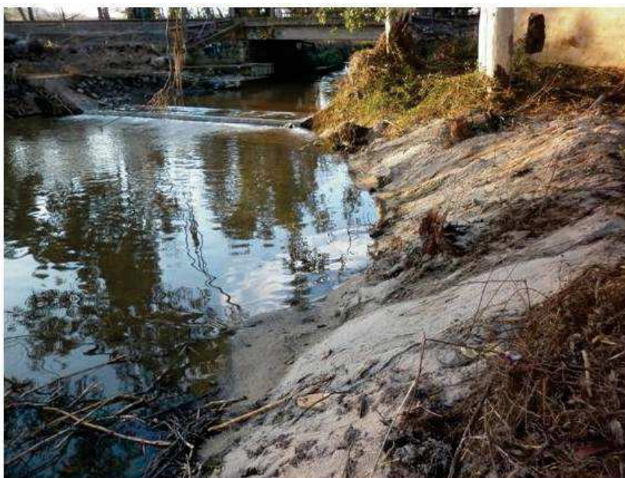
21 - Ponte Ferroviario S'Eligheddu. Vista da valle in Sx. In primo piano sponda dissestata ed incremento vistoso della sezione
