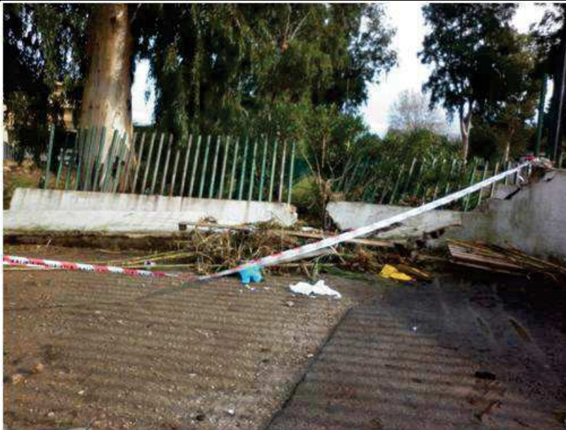
Fig.3 . Ribaltamento di parte del muro di recinzione trasversale alla posizione del canale sul lato dx subito a valle dell'attraversamento
