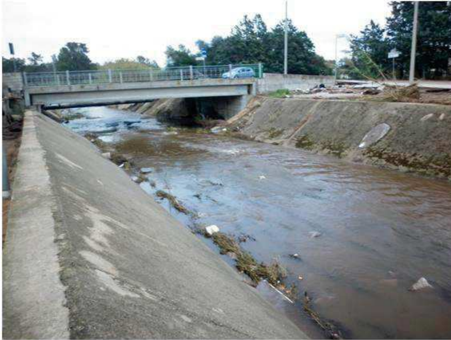
Foto 18- Ponte via Tre Venezie. Vista da Sx e da monte. Testimonianze del rigurgito per sezione del tutto insufficiente. Il ponte è relativamente recente
