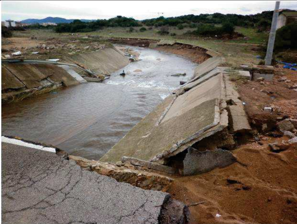
10 - S'Eligheddu: vista da ponte danneggiato verso valle- Scalzamento difese spondali lato Dx e massiccia asportazione per decine di mt in Dx, come effetto della cinematica della corrente. Complessivamente risultano danneggiate e non funzionali alcune centinaia di metri di manufatto.
