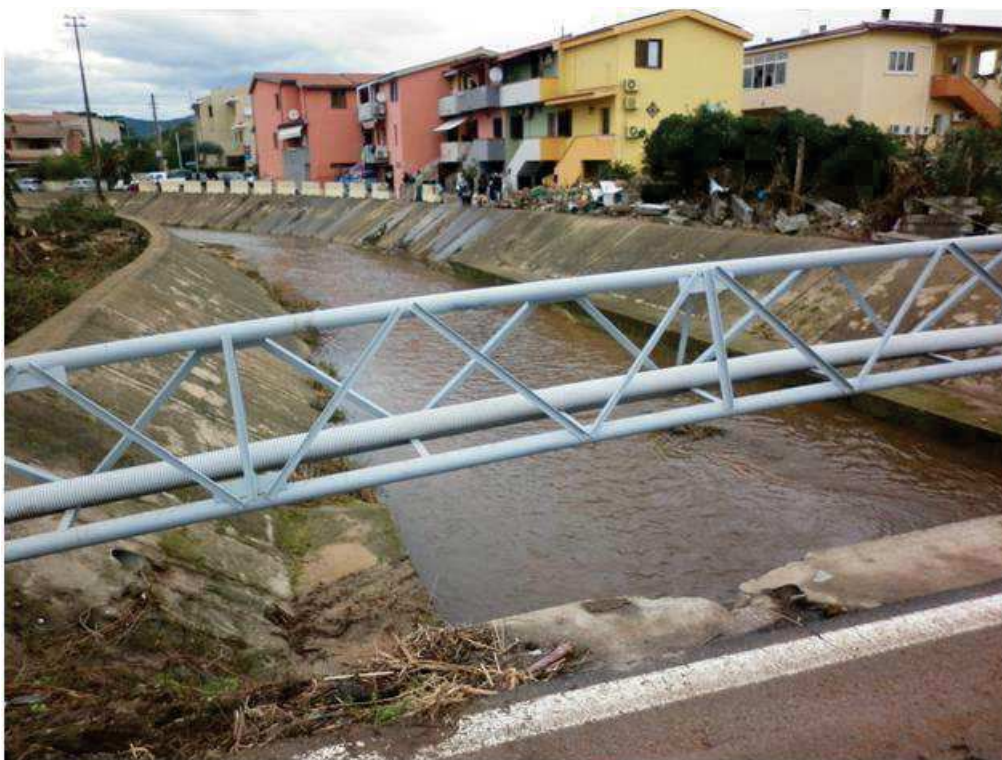
11 - S'Eligheddu: vista da ponte danneggiato verso monte. Case allagate in Sx (via Gessi).
