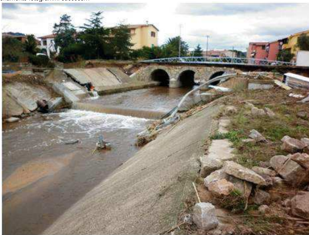
9 - S'Eligheddu : Ponte sulla SS127 (visto da valle): Tracimato e danneggiato. A valle difese spondali danneggiate per sottoescavazione. In primo piano la Rampa a valle del ponte
