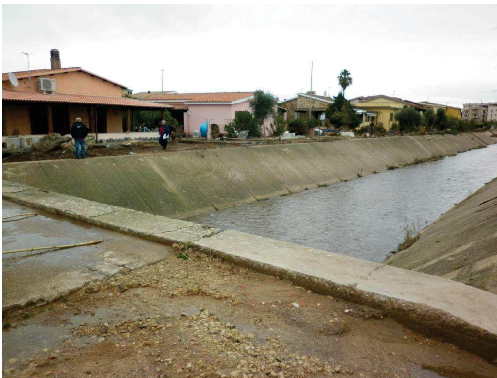
13 - S'Eligheddu: vista da monte verso valle, da ponticello presso via dell'Agrifoglio. Tutte le case (dotate anche di piano interrato) delle vie adiacenti al canale in Sx sono state allagate fino a ponte principale di valle (via Tre Venezie), realizzato poco più di 10 anni fa. Lo specifico tratto non manifesta particolari dissesti alle difese spondali. Il ponticello è stato abbattuto nei giorni successivi alla foto del 22/11/2013
