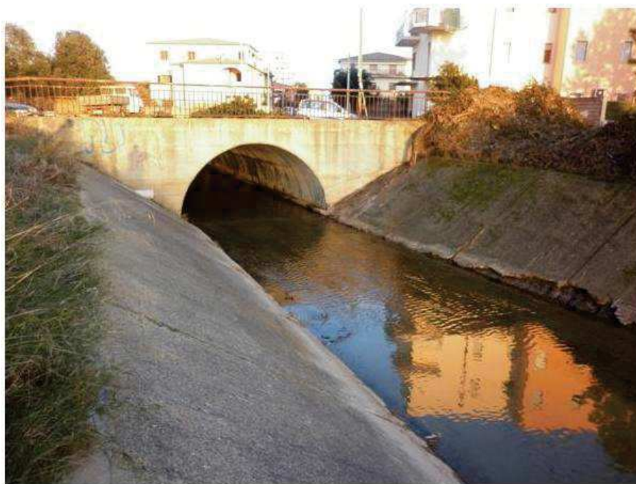
Fig. 10 - Attraversamento di via Stromboli. Ripresa da Sx, da monte verso valle. L'opera è palesemente incongrua: il ponte tubo è posteriore alla realizzazione della sezione trapezia in cemento
