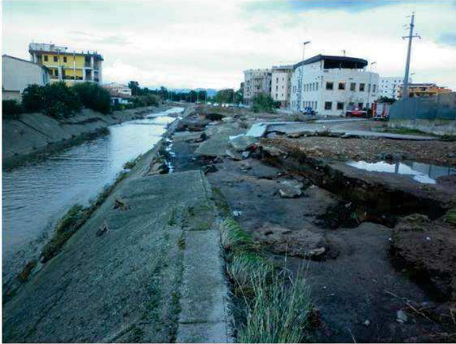
16- S'Eligheddu: Protezione spondale danneggiata e rimossa per erosione e scalzamento sponda canale (sponda Dx in primo piano)
