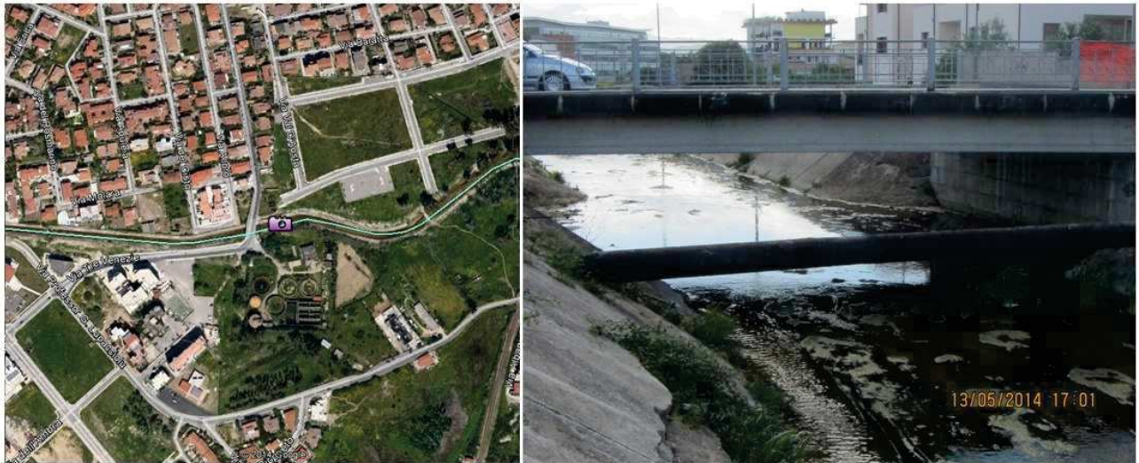
Figura 42. Ponte di via Tre Venezie Riu Seligheddu - Si nota l'attraversamento dei sottoservizi che agevola l'ostruzione della luce. Vista da valle verso monte.
