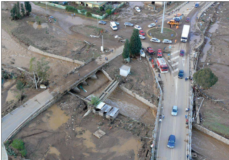
Figura 78 - Due ponti e una condotta idrica riducono, nello spazio di poche decine di metri, la sezione idraulica del Rio San Gerolamo in prossimità della foce.
