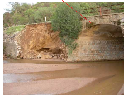
SP1 Ponte in prossimità della Caserma della Forestale. Il corso d'acqua ha tracimato l'opera d'arte erodendo il rilevato a valle e provocando lo scalzamento dei muri
