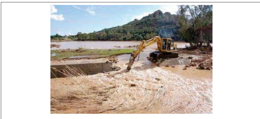
Figura 69 - Demolizione soglia sfiorante e abbassamento del livello del lago di circa 1.3 m -23.10.08
