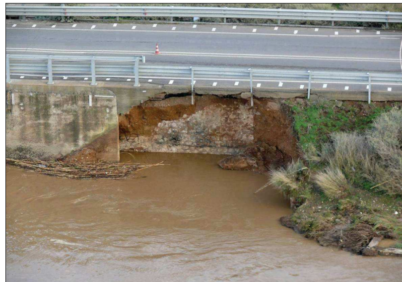
Figura 79 - Cedimento del rilevato stradale
