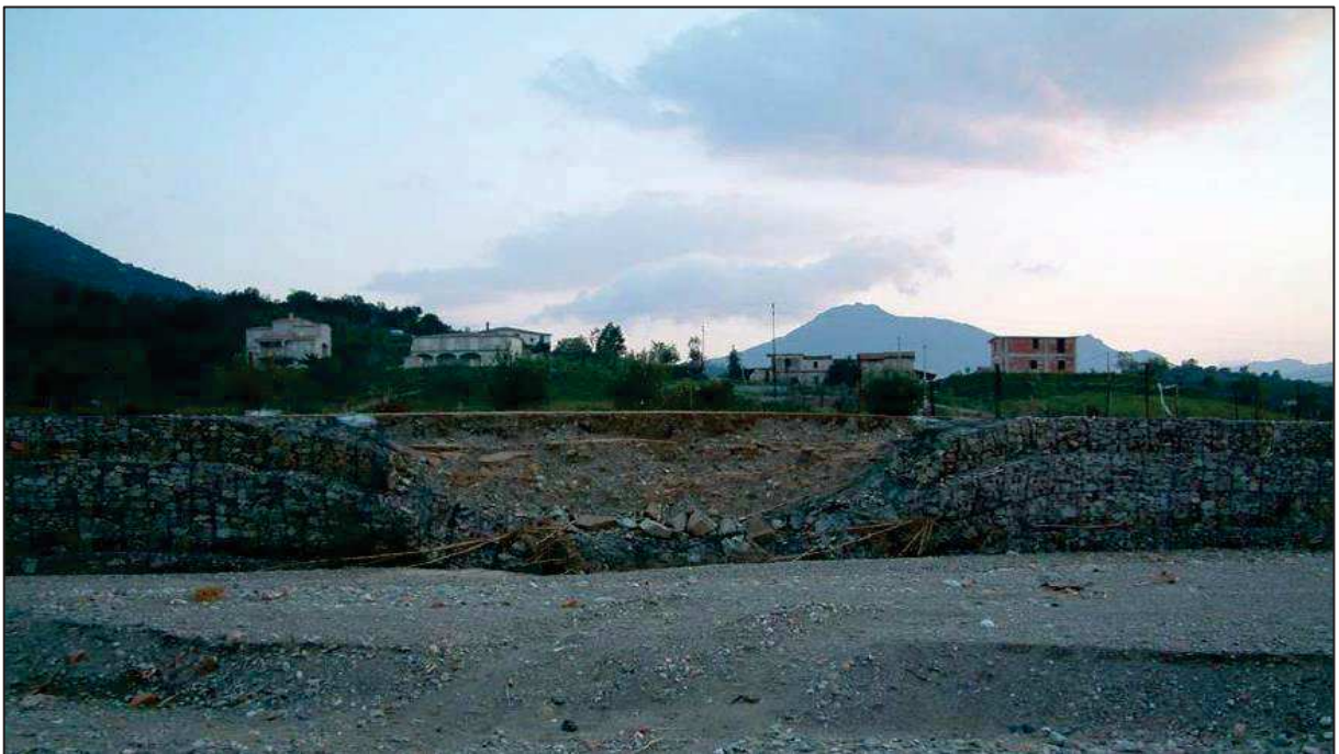
Figura 1.5 – Tratto valle del rio Serrasomu: cedimento opera di difesa spondale dx in gabbioni
