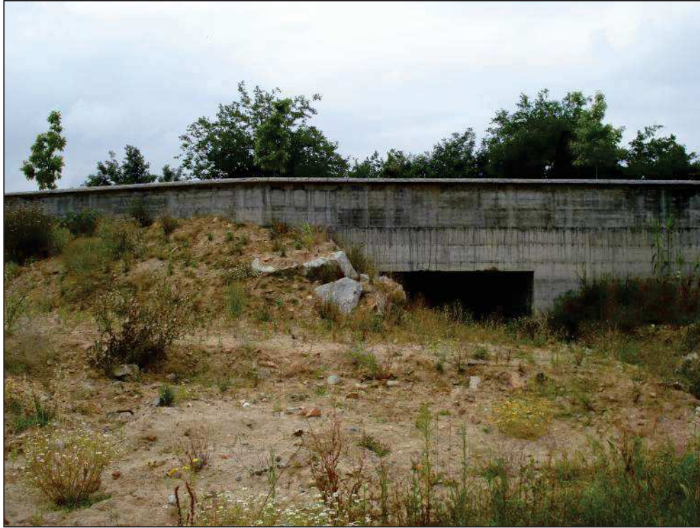
Figura 6.4 – Sbocco sul rio Foddeddu (via delle Lavandaie) di un canale tombato di raccolta acque meteoriche
