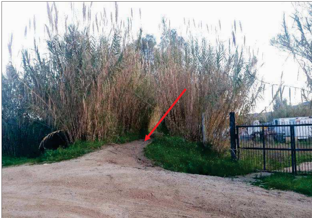
Figura 2.14 – Tratto a valle del ponte di ferro: argine in terra destro (notare le pessime condizioni del rilevato);
