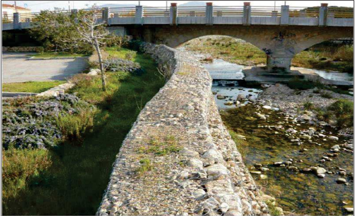
Figura 1.5 –Esempio di rialzo spondale in gabbioni staticamente e idraulicamente non funzionale
