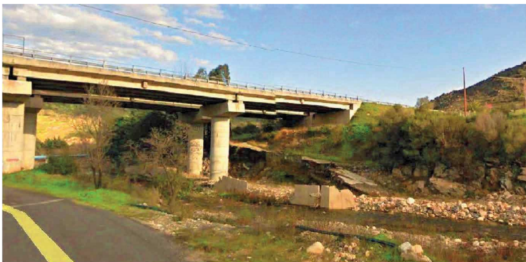
Figura 14 - Erosione del rilevato stradale sotto il ponte della S.S. 131
