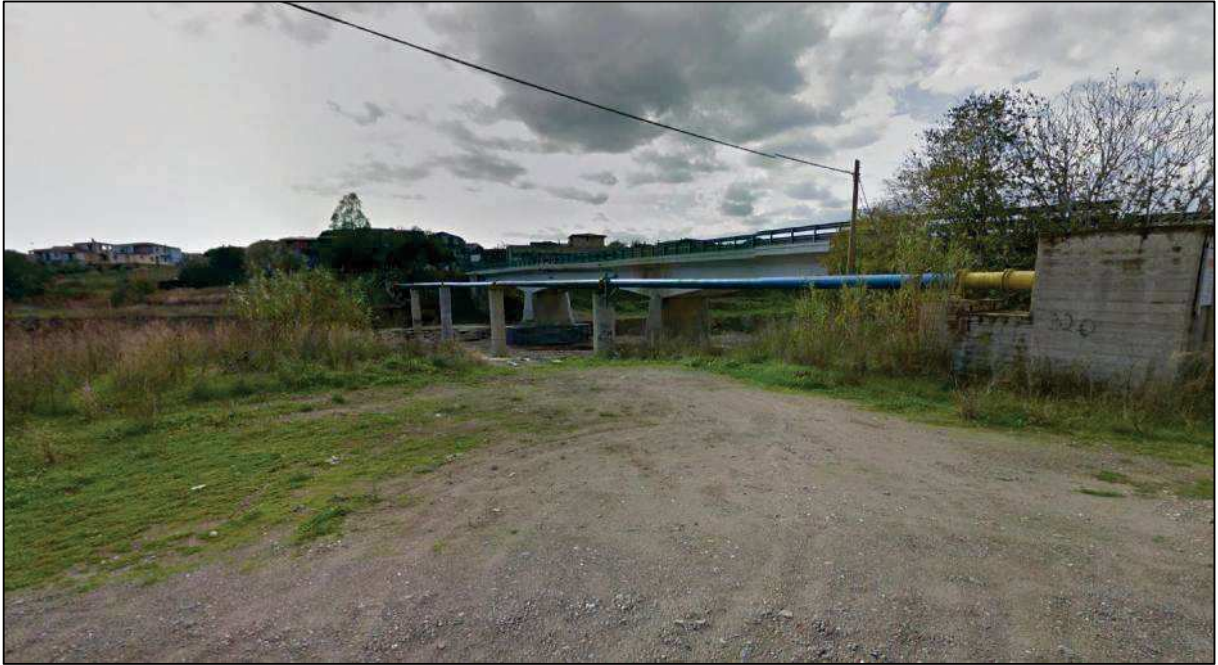
Figura 1.6 –Attraversamento acquedottistico a valle del ponte sulla SS 125
