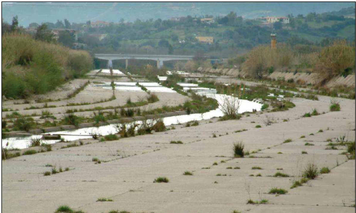
Figura 6.4 – Canalizzazione trapezia in calcestruzzo con savanella a valle della SS 125 (fonte PSFF)
